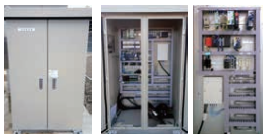
●屋外盤外側 ●屋外盤内側 ●中板
